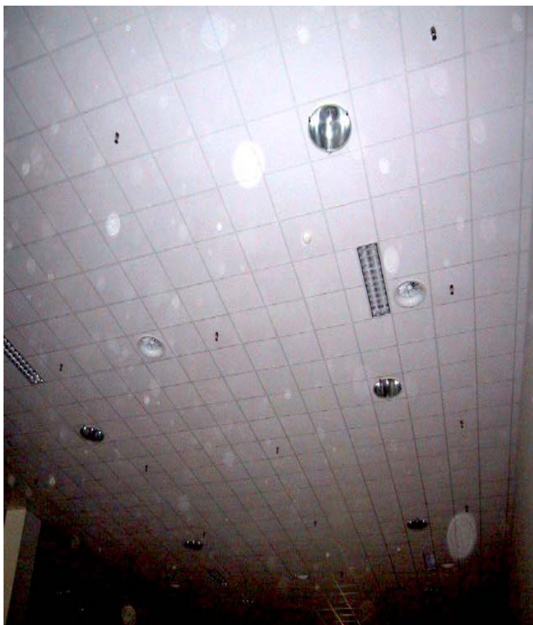
吊顶型喷头布置
